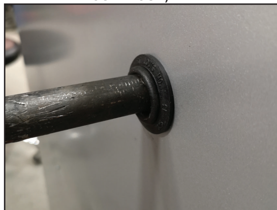
FIGURE 28 - RACCORDEMENTS DE LA CONDUITE DE GAZ DE LA FOURNAISE (NOTEZ L'ANNEAU EN CAOUTCHOUC)
