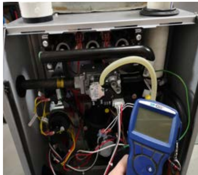
FIGURE 30 - MANOMÈTRE QUI MESURE LA PRESSION DU GAZ AU COLLECTEUR
